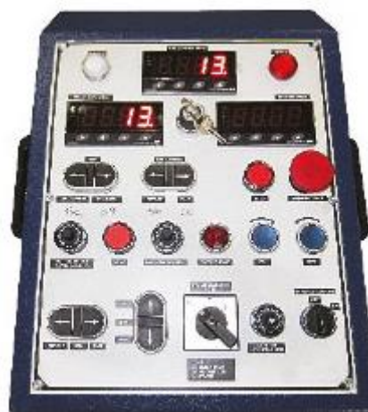
Glavna kontrolna ploča I
